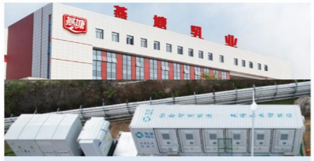
燕塘乳业1.5MW光伏+2MW/4MWh储能项目
